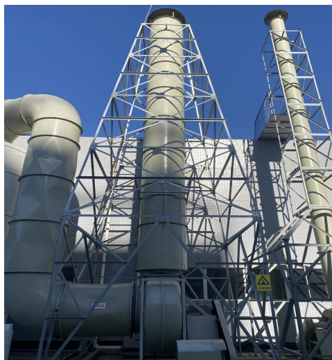
碱喷淋塔+排气筒 DA002
