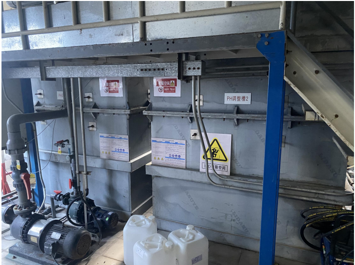
污水处站 pH 调节池
