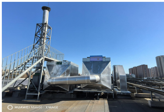
二级活性炭吸附+排气筒 DA001
