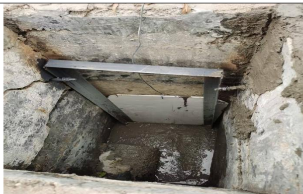
应急池切换装置
